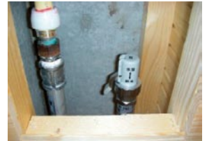
水道凍結防止栓（水道管の水を抜き凍結を防ぐ）
