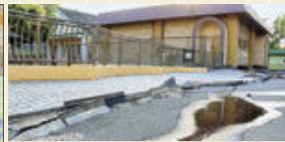
↑4 液状化現象で舗装された地面に亀裂が入った様子(熊本県、熊本市、2016年)
